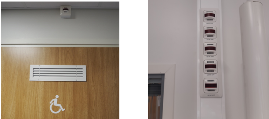
Larmljus ovanför en toalettdörr och larmpanel i kansliet
