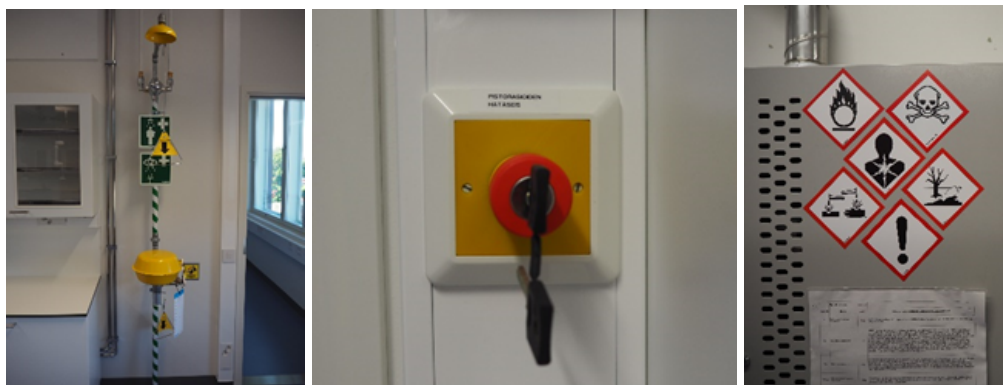
Nöddusch, ögondusch, nödbrytare och varselmärkningar på dörrar till kemikalieskåp
