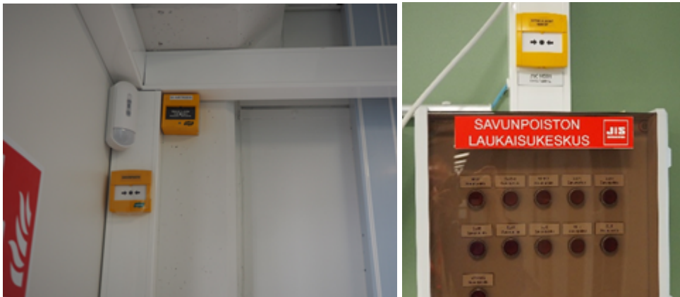
Tryckknappar för nödstopp av ventilation vid D-ingången och B-ingången
