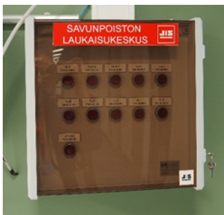
Utlösarcentral för rökventilation vid B-ingången
