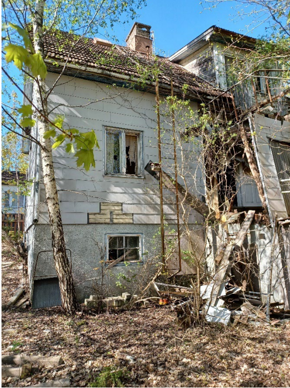
Den fallfärdiga huvudbyggnaden på fastigheten Björkkulla 3:35. Kiinteistöllä Björkkulla 3:35 oleva rappeutunut päärakennus.
