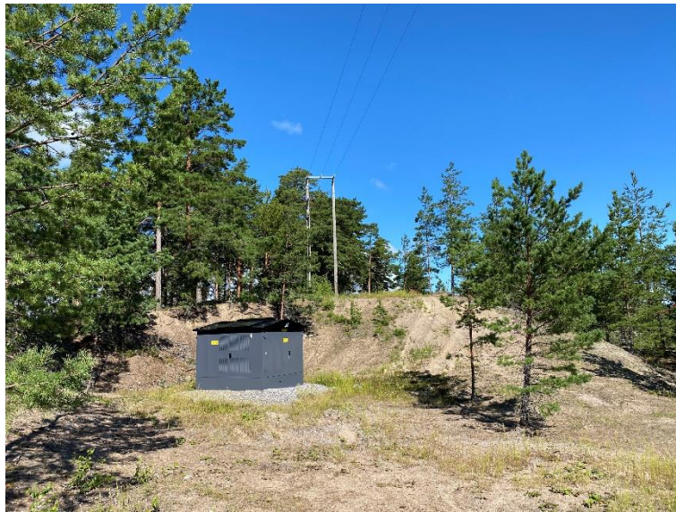
Transformator och 20 kV kraftledning i planområdets sydvästra del.
