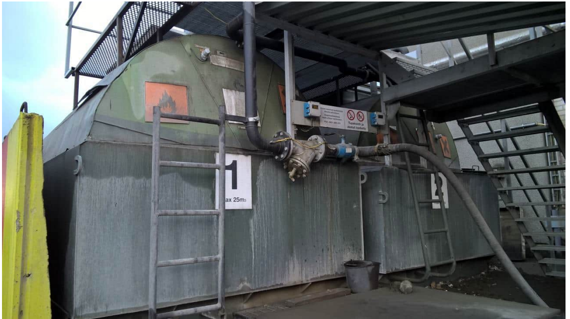
Kuva 5. Kierrätyspolttoöljysäiliö ja kevytpolttoöljysäiliö
