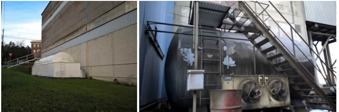
Kuva 4. Raskaspolttoöljy- ja kevytpolttoöljysäiliöt
