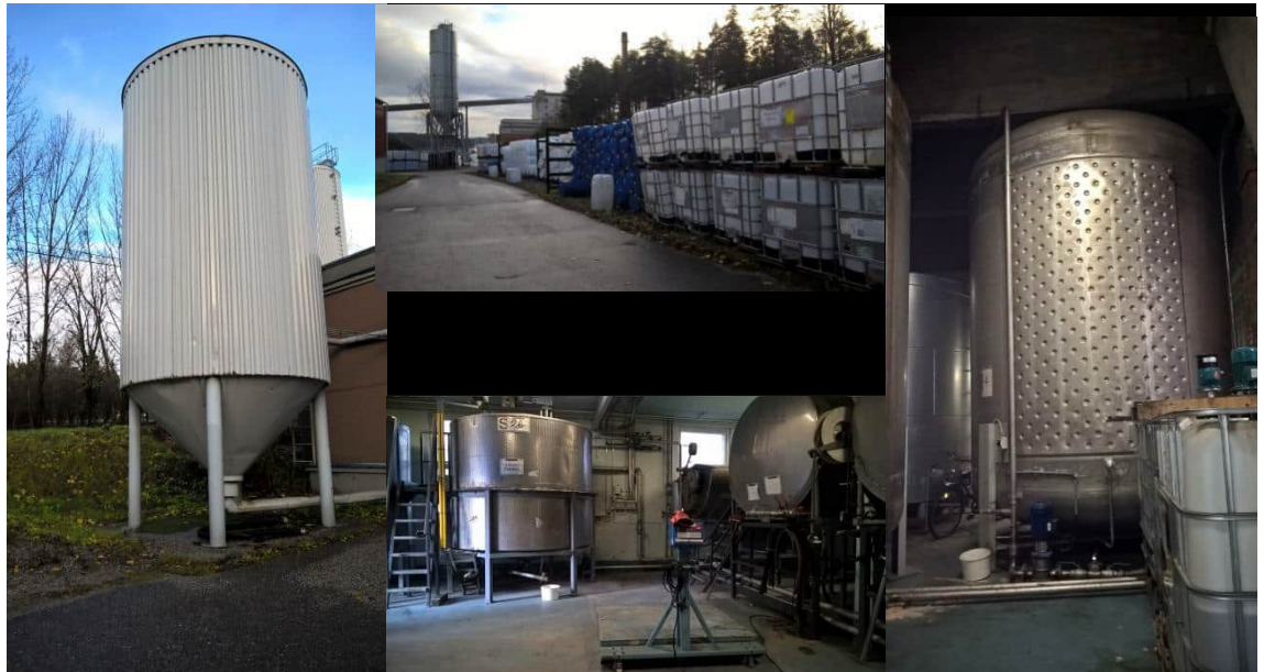
Kuva 9. Lisäaineiden varastosäiliöitä. Vasemmalla ulkotiloissa, keskellä alhaalla ja oikealla sisätiloissa ja ylhäällä keskellä tyhjiä lisäainesäiliöitä ulkovarastoinnissa.
