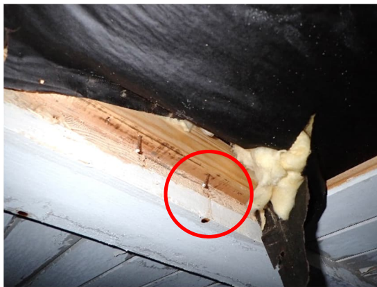
Kuva 47. Avauksessa R10 havaittiin pientä valumajälkeä elementin sauman kohdalla ja ruostuneita nauvoja.
