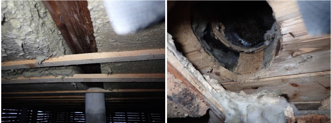
Kuvat 8 ja 9. Alapohjan lisäeristystä puuttuu paikoitellen. Alapohjassa oli paikkaamaton vanha läpiviennin kohta wc-tilojen kohdalla.
