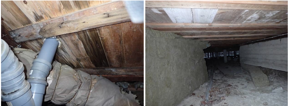
Kuvat 10 ja 11. Wc-tilojen alla ja vieressä havaittiin kosteusjälkiä ja valkoista kasvustoa alapohjan aluslaudoissa.
