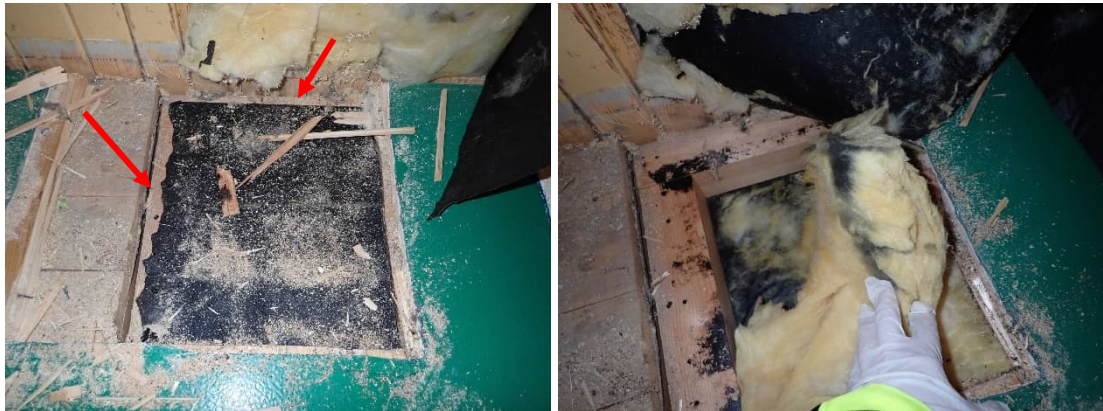
Kuvat 14 ja 15. Alapohjan ilmansulkuna toimivan tervapahvin todettiin olevan hyvin epätiivis ulkoseinän ja elementtien välisten liittymien kohdalla (nuolet). Lämmöneristeessä todettiin ilmavuotoihin viittaavaa mustumista. Kuvat ovat avauksesta R14.
