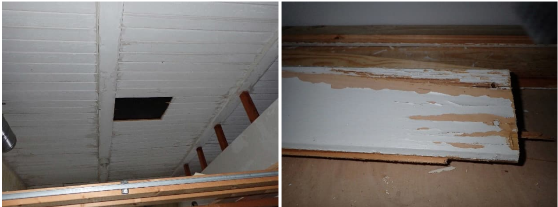
Kuvat 41 ja 42. Liikuntasalin varaston katon maalipinta lohkeili vasemmanpuoleisen tilan kohdalla. Kohtaan tehtiin avaus, josta irrotettu paneeli oikeanpuoleisessa kuvassa.
