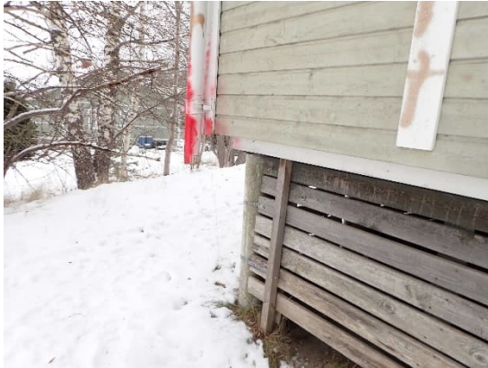
Kuva 4. Osa syöksytorstista on katki.
