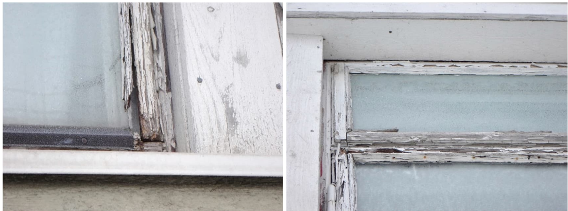
Kuvat 35 ja 36. Luoteissivun huonokuntoisia ikkunoista.
