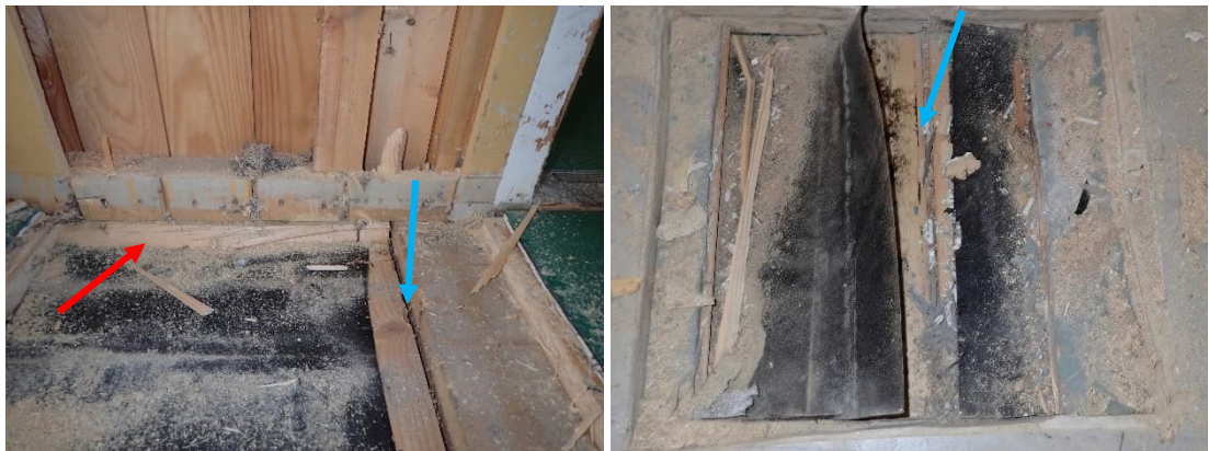
Kuvat 16 ja 17. Väliseinien kohdalla lattian laudoitus ja tervapahvi jatkuivat väliseinien alle (punainen nuoli). Elementin liittymäkohdassa oli iso rako avauksessa R15 ja kittiä tms. avauksessa R16 (siniset nuolet).
