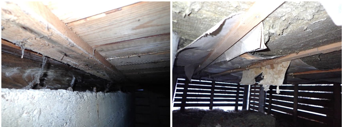
Kuvat 12 ja 13. Kosteusjälkiä havaittiin myös lämmönjakohuoneen betonirakenteita vasten olevassa puussa sekä keittiön lähellä lisäeristeen alapinnan pahvissa.
