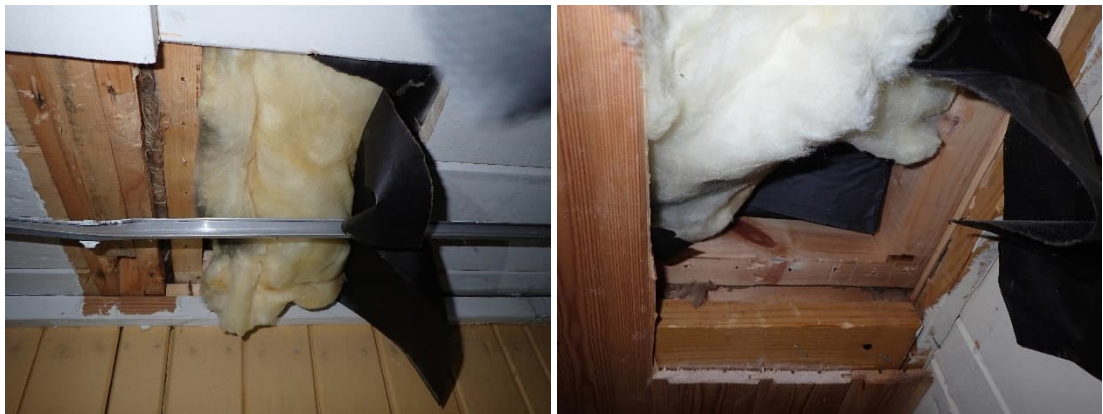
Kuvat 45 ja 46. Yläpohjan eristeissä oli ilmavuotoihin viittaavaa mustumista. Kuvat ovat avauksista R9 ja R12.
