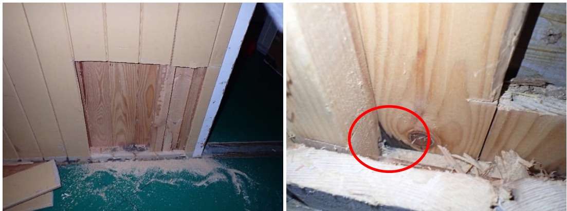
Kuvat 37 ja 38. Väliseinien sisällä ei ole eristettä. Wc-tilan avauksessa R8 havaittiin seinän sisällä mahdollisesti kosteuteen viittaavaa tummentumaa (ympyrä).
