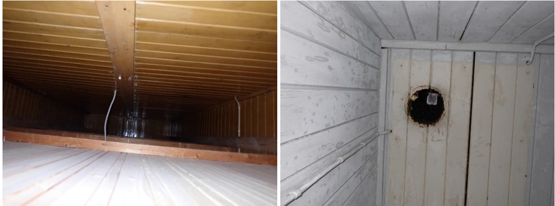
Kuvat 48 ja 49. Keittiön alakaton takana oli melko korkea tyhjä tila ja wc-tilan katon levytyksen takana oli muutoin ummistamaton poistoilmakanava.
