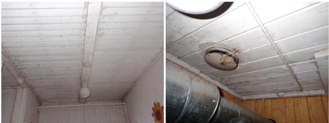
Kuvat 43 ja 44. Kattopinnat olivat tarkastushetkellä kuurassa. Toisen wc-tilan katossa olevan poistoilmaventtiin kohdalla oli kosteusjälkiä.
