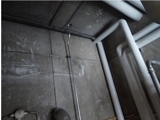
Kuva 1. Näyte AH16. Asbestipitoisia kuitusementtilevyjä rakennuksen lämmönjakohuoneessa.
