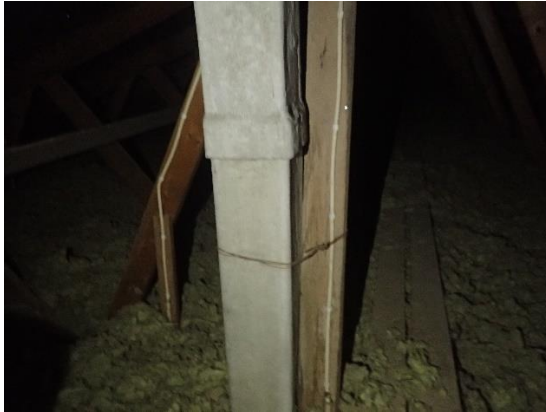
Kuva 3. Asbestipitoista kuitusementtikanaavaa rakennuksen yläpohjassa.
