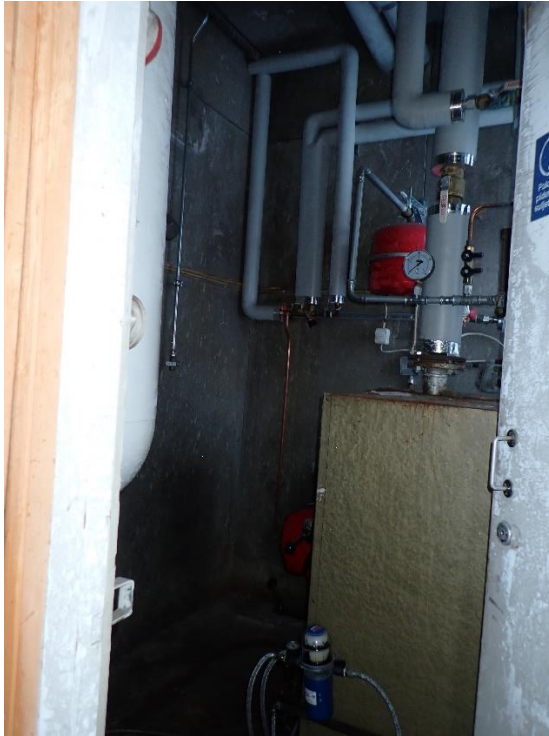
Kuva 5. Asbestipitoista eristettä ja nauhaa lämmityskattilan sisällä.
