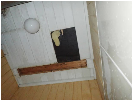
Kuva 7. Näyte AH8. Rakennuksen yläpohjan tervapaperi ei sisällä asbestia eikä sen PAH(16)-yhdisteiden kokonaispitoisuus ylitä vaarallisen jätteen raja-arvoja.
