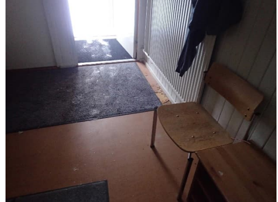
Kuva 2. Näyte AH2. Eteisen lattiassa osin käytetty punertavan oranssi muovimatto ja sen liima eivät sisällä asbestia.
