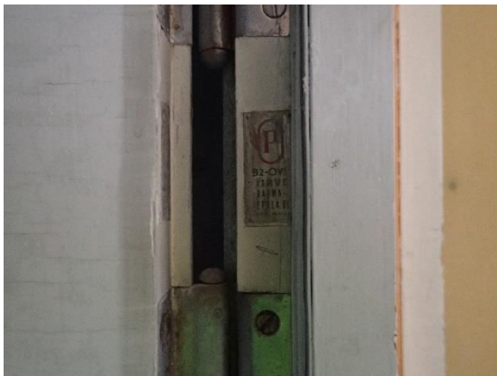
Kuva 2. Palo-ovi, jonka sisällä asbestipitoinen palopahvi.
