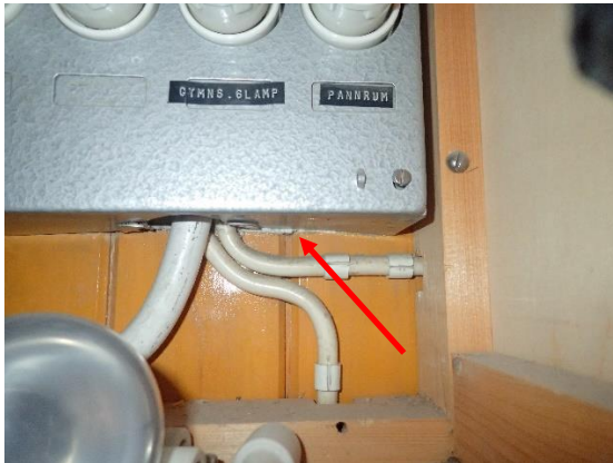
Kuva 4. Asbestipitoista palopahvi sähkötaulun taustassa.
