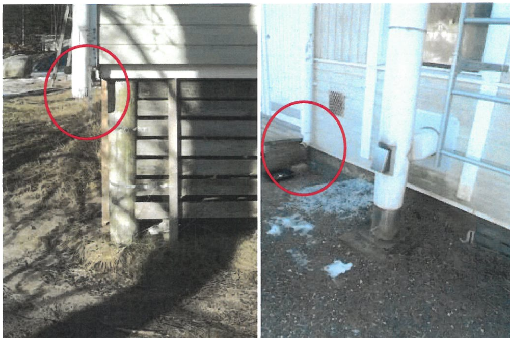
Kuvat 1 ja 2. Kattovesiä ei ole johdettu pois rakennuksen vierustalta.
