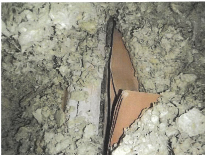
Kuva 20. Ilmavuotoja yläpohjatilasta sisälle todettiin elementtien saumojen kohdilta. Yläpohjan tiivistyspahvi ei ole yhtenäinen elementtisaumojen kohdilla.
