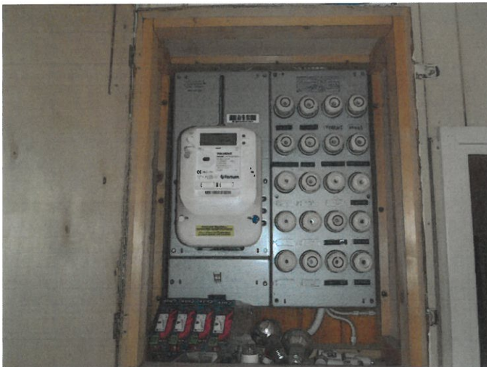
Kuva 34. Sähkökeskus johon on lisätty uusi sähkömittari.
