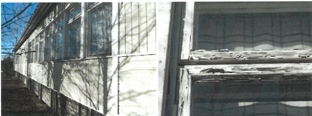
Kuvat 11 ja 12. Ikkunoiden ulkopokat ja karmit ovat huonossa kunnossa.
