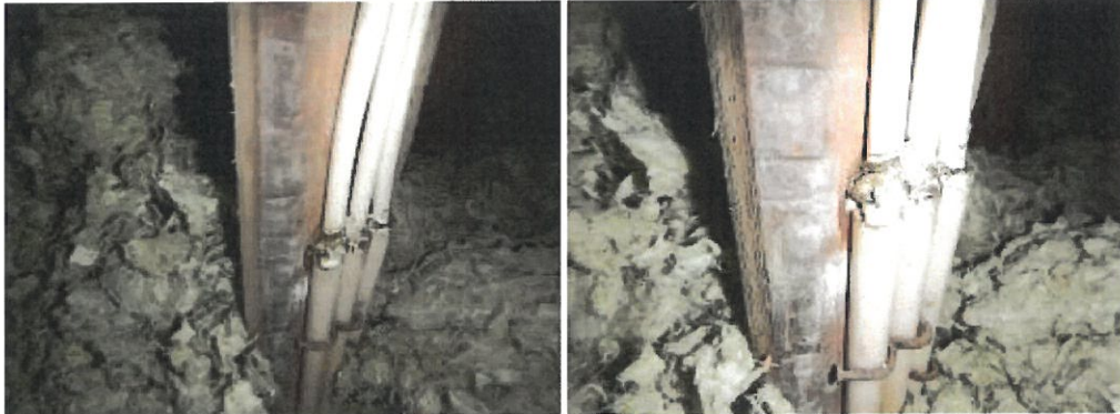
Kuvat 17 ja 18. Yläpohjatilasta havaittiin ilmavuotoja sisälle mm. sähköputkien kautta.
