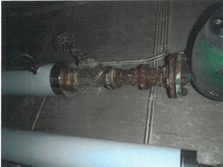
Kuva 33. Lämpöjohtojen pinnoilla havaittiin pannuhuoneessa ruostetta.
