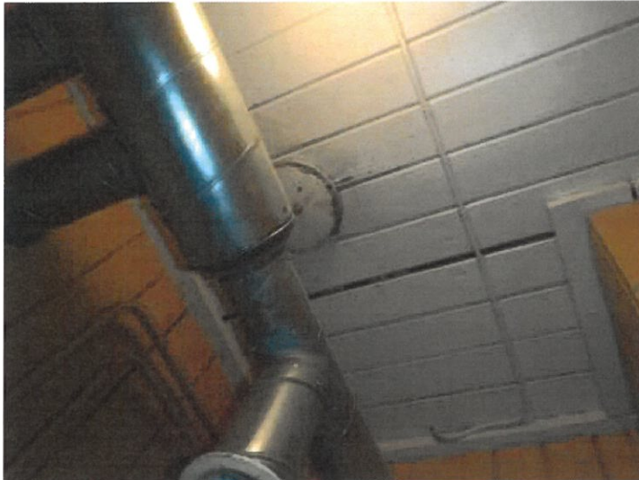
Kuvat 30. Pukuhuoneen wc-tilan katossa on vanhan painovoimaisen ilmanvaihdon poistoventtiili.
