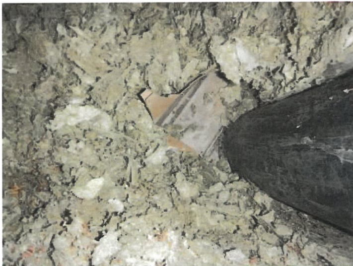
Kuva 19. Ilmavuotoa havaittiin myös yläpohjan läpivientien kautta.
