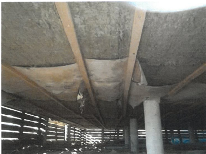
Kuva 3. Alapohjan villoituksen (lisäeristys) alla ei ole tuulensuojalevyä.
