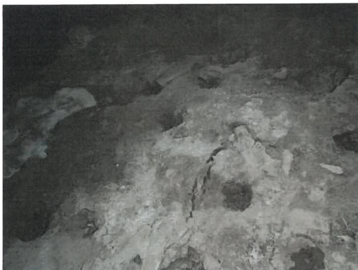
Kuva 9. Ryömintätilan maapohjassa on paikoitellen vettä.
