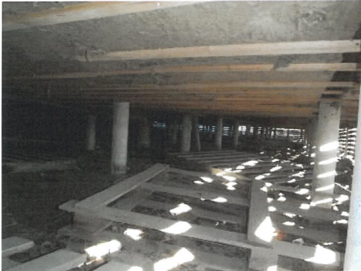
Kuva 4. Ryömintätilan maapohjassa on runsaasti rakennusjätettä.
