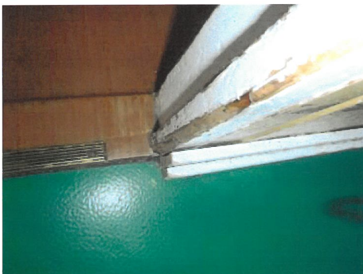
Kuva 24. Kynnysten kohdilta virtaa vuotoilmaa sisälle ryömintätilasta alapohjan läpi.
