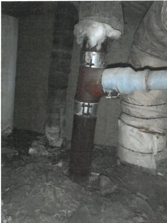
Kuva 6. Viemärin liitos ei vaikuta tiiviiltä.
