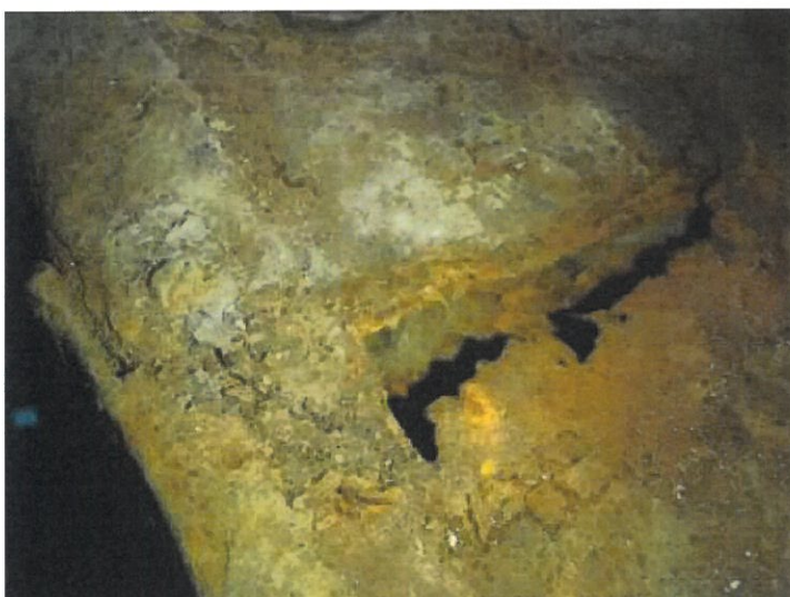
Kuva 32. Lämmityskattilan kuoren ruosteaurio.
