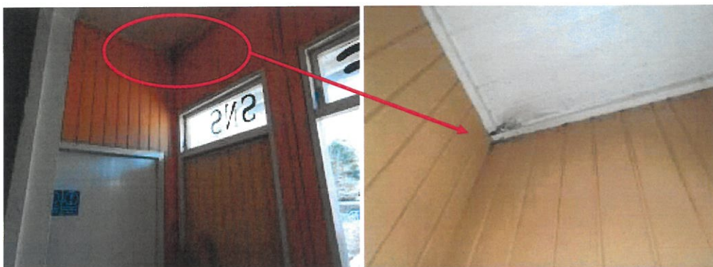
Kuvat 25 ja 26. Ilmavuotokohta lämmönjakohuoneesta tuulikaappiin.
