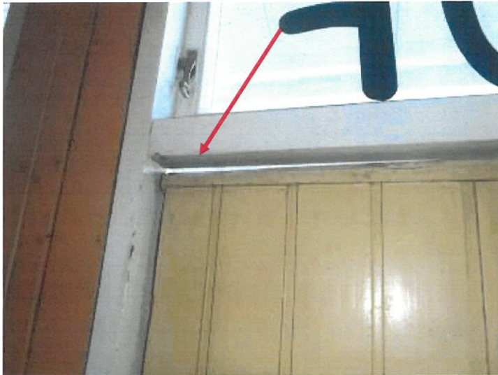
Kuva 27. Ulko-ovi ei ole tiivis.
