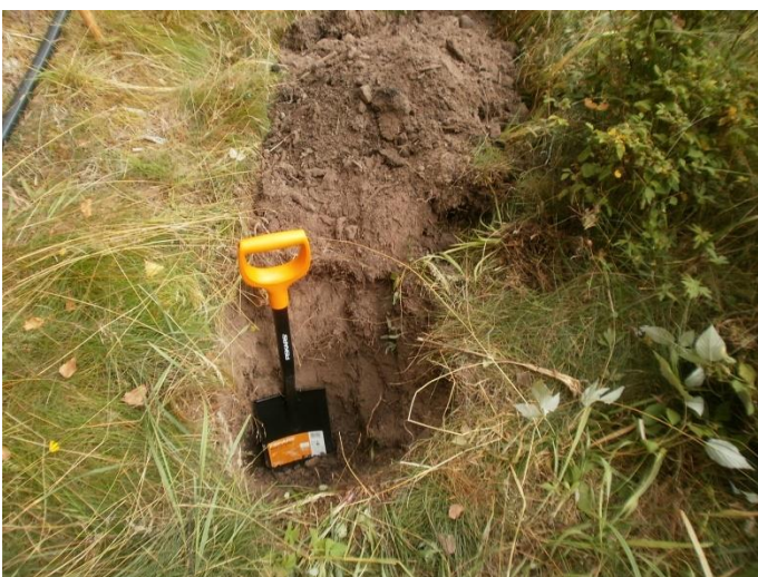
Bild 7a-b. Dolt dräneringsrör i dike nr 1
