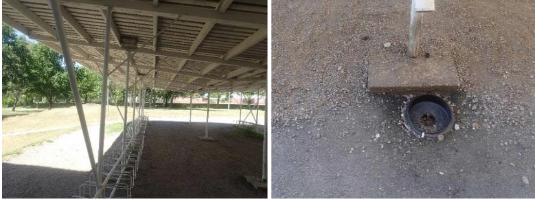
Kuvat 48 ja 49. Pohjoispuolen pyöräkatos on metalli- ja puurunkoinen. Kattolapheet kallistuvat katoksen keskilinjalle, josta sadevedet on johdettu syöksytorvella kohti rännivesikaivoa.
