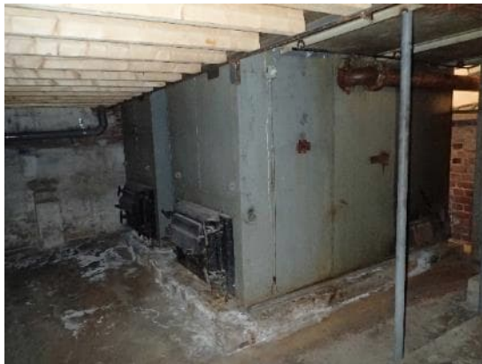
Kuva 54. Lämmönjakohuoneessa havaittiin runsaasti kosteusjälkiä.
