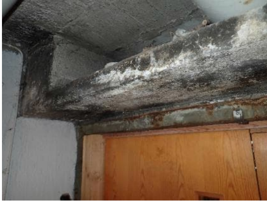
Kuvat 17. Lämmönjakuhuoneen oven kohdalla sisätilojen puolella havaittiin pihakannen reunalla selkeitä jälkiä vesivuodoista. Rakenteessa ei havaittu koholla olevia kosteusarvoja.
