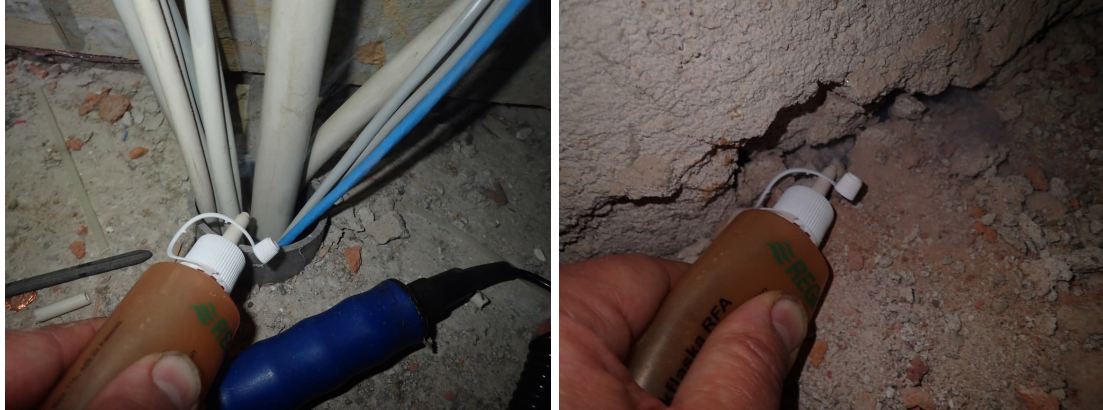
Kuvat 217 ja 218. Auditorion katsomon alle virtasi ilmaa välipohjan johtoläpiviennistä sekä välipohjan ja väliseinän liittymästä.
