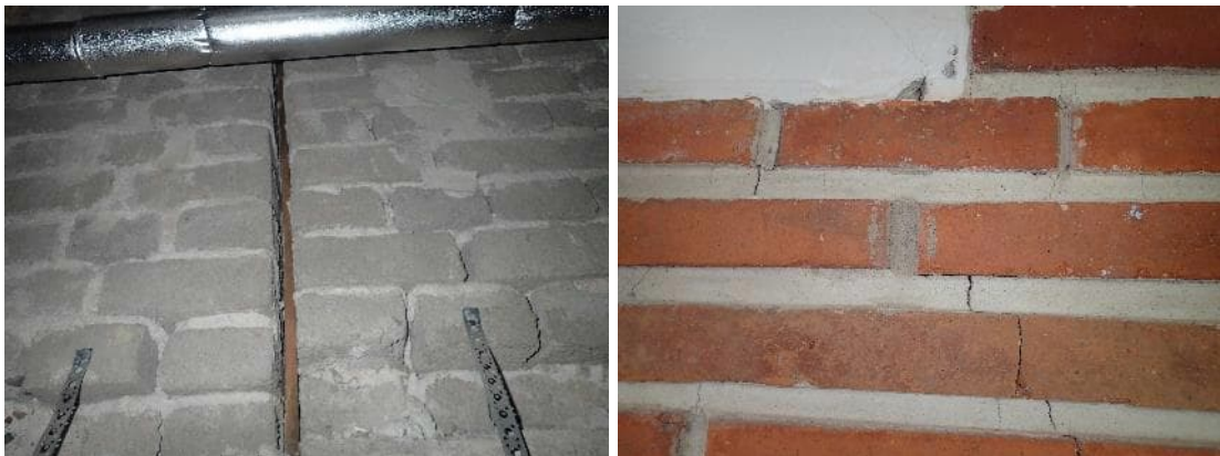
Kuvat 119 ja 120. Alakaton taustalla käytävällä 129 havaittu avoin ulkoseinän liikuntasauma ja halkeama seinässä liikuntasauman alapuolella.
