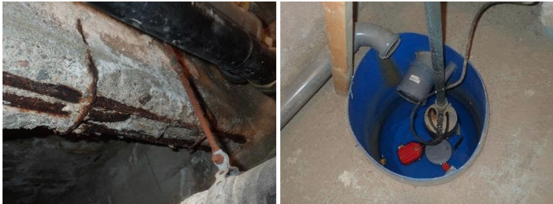
Kuvat 69 ja 70. Altaan länsipuolella olevassa tilassa oli vaurioitunut välipohjapalkki. Tilan lattialla oli kaivo, jossa on viemäriä pumppaava uppopumppu.
