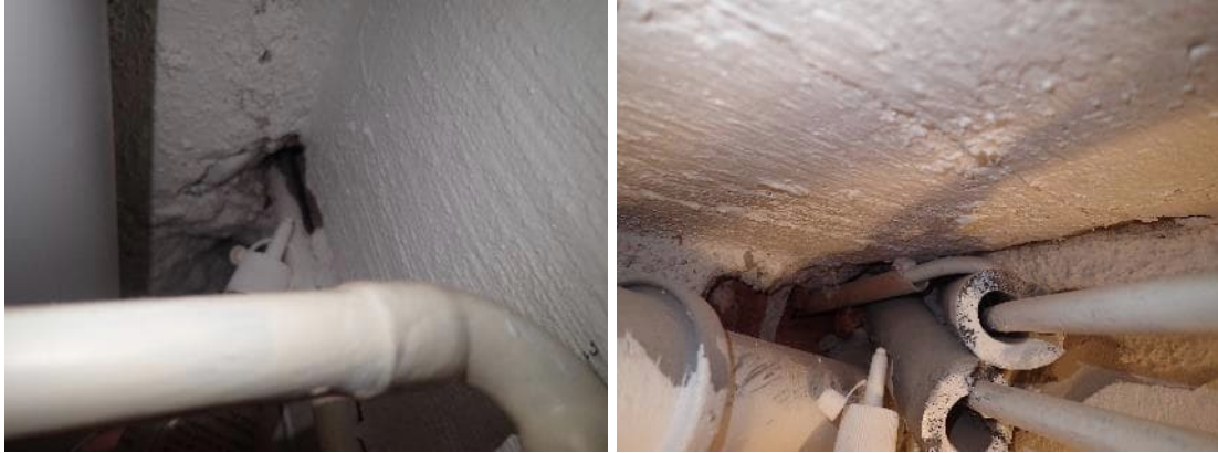
Kuvat 212 ja 213. Esikoulun varastotiloissa havaittiin epätiivitä välipohjaläpivientejä.
