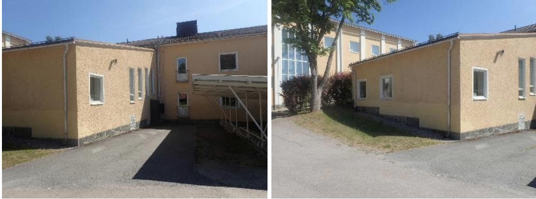
Kuvat 135 ja 136. F-osan pohjoisseinän alaosa on maalattu, mahdollisesti myös rappaus on korjattu.
