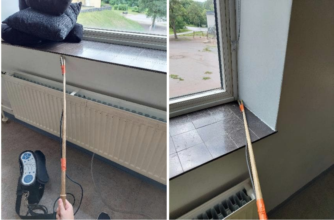
Kuvat 117 ja 118. Ulkoseinän merkkiainekokeessa MA7 havaittiin ilmavuotoa ikkunapenkin ja ulkoseinän liitoksesta (vähäinen ilmavuoto) ja ikkunan tilkevälin kautta (merkittävä ilmavuoto).
