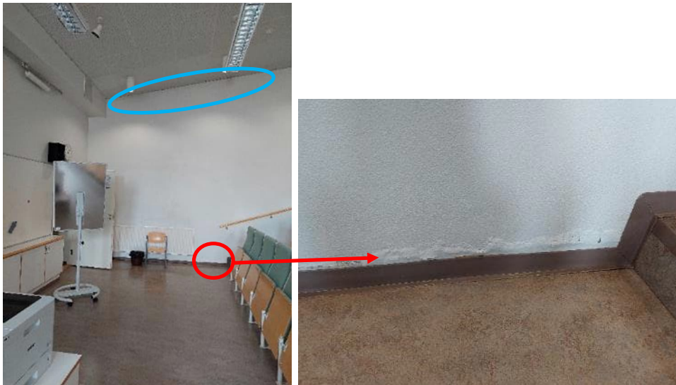
Kuvat 137 ja 138. F-osan itäseinustalla havaittiin vuotojälkiä ulkoseinän yläosassa (sininen ympyröinti). Kohdassa ei havaittu koholla olevia kosteusarvoja. Auditorion ulkoseinä kupruilee seinän alaosassa (punainen merkintä). Kohdassa havaittiin koholla olevia kosteusarvoja.
