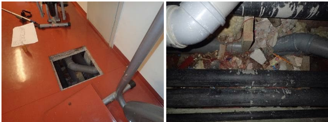
Kuvat 61 ja 62. Käytävän kohdalla olevassa putkikanaalissa oli paljon roskaa ja rakennusjätettä pohjalla.
