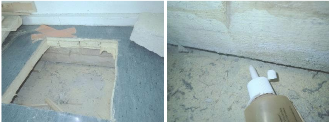
Kuvat 59 ja 60. Opetustilan (entinen talonmiehen asunto) alapohjan rakenneavaus R3. Avauksesta havaittiin merkksivulla ilmavuotoa ulkoseinän suuntaan.
