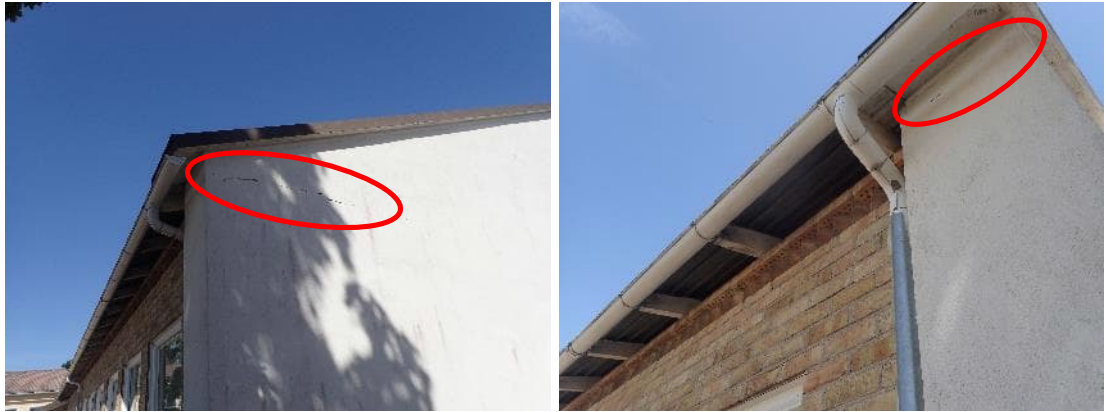
Kuvat 125 ja 126. E-osan lounaisnurkan rapatussa julkisivussa on lounaisnurkassa halkeama.
