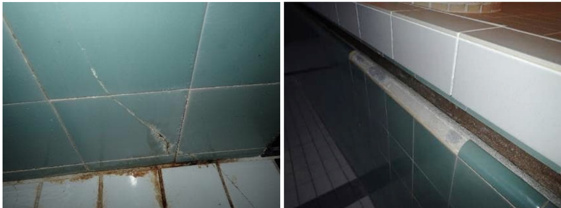
Kuvat 57 ja 58. Altaassa havaittiin rikkonaisia laattoja ja altaan yläreunasta puuttui laattoja vedenkeruukourun vierestä. Kourun pinnoilla ei ole keraamisia laattoja.
