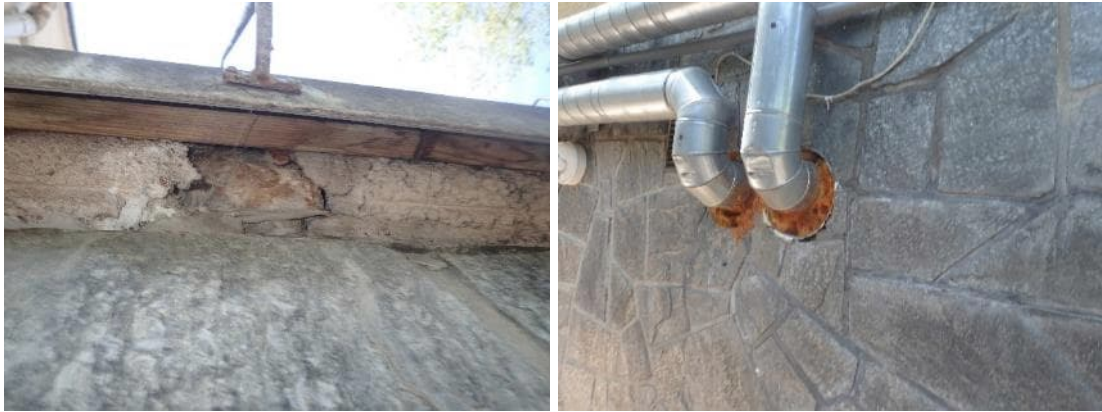
Kuvat 87 ja 88. Pihakannen reuna on rapautunut. Talotekniikkaläpivientejä ei ole suojattu.
