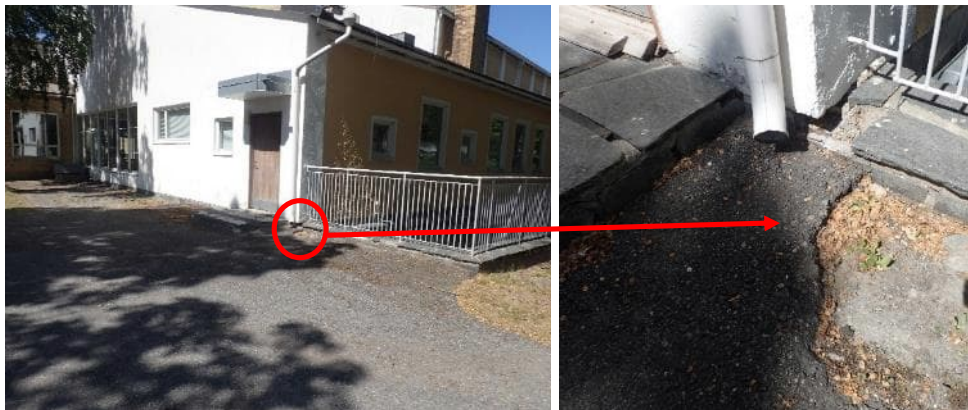
Kuvat 22 ja 23. Puuttuva rännivesikaivo aiheuttaa kosteusrasitusta rakenteille.
