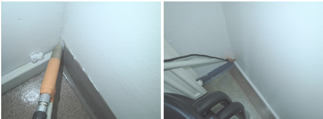
Kuvat 215 ja 216. Merkkiainekokeessa MA3 havaittiin pistemäistä ilmavuotoa välipohjasta luokkien 136 ja 139 välisen levyrakenteisen väliseinän molemmiin puolin.
