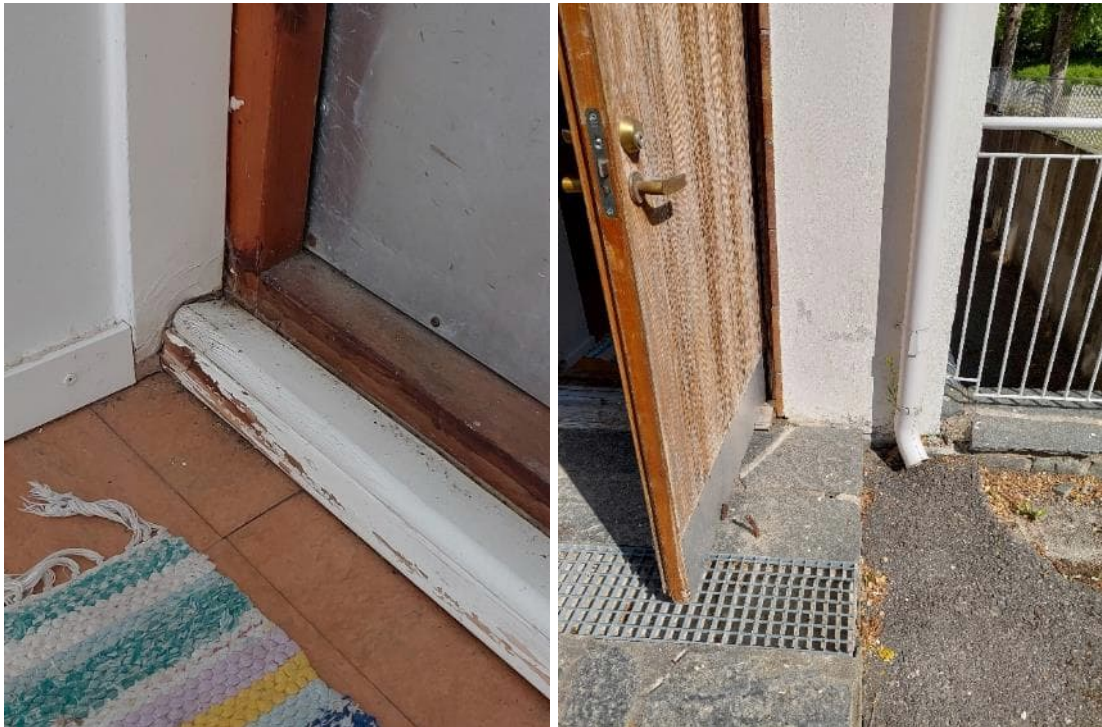
Kuvat 93 ja 94. Kaakkoisnurkan oven kohdalla havaittiin kosteusvaurioita ovikarmissa, kynnyksessä ja karmillistoituksessa.
