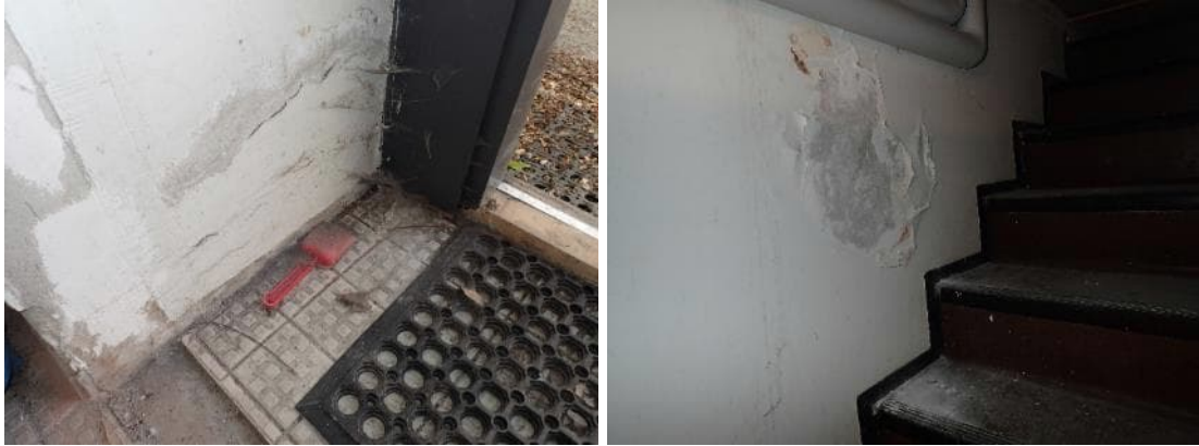
Kuvat 91 ja 92. Kellarikerroksessa havaittiin seinien alaosissa koholla olevia kosteusarvoja ja maali- ja tasoitepintojen kupruilua.
