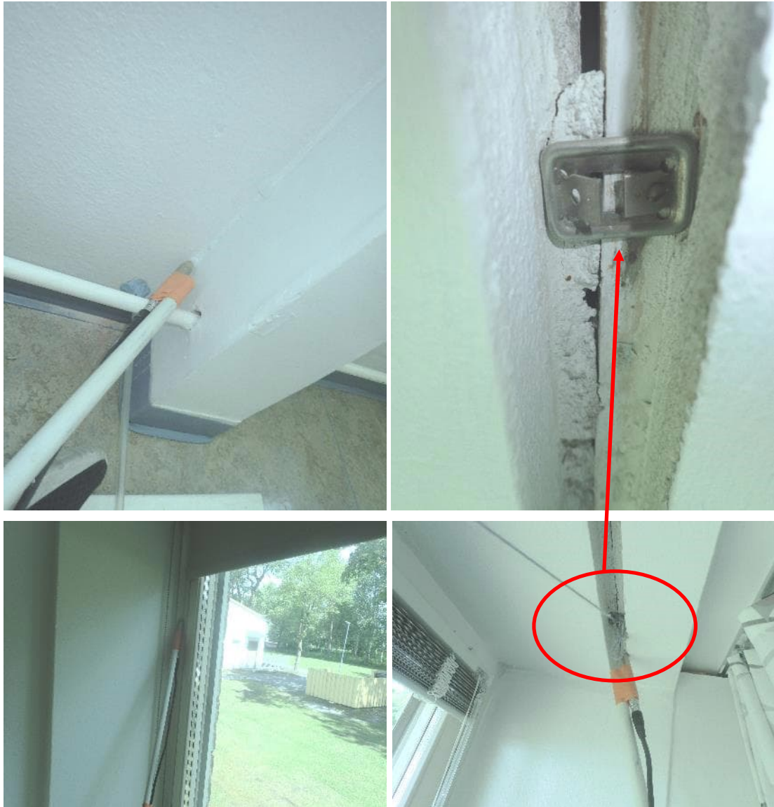
Kuvat 131, 132, 133 ja 134. Merkkiainekokeessa MA4 havaittiin ilmavuotoa poistetun väliseinän ja ulkoseinän liitoksesta (kuva 131), poistetun verhokiskon syvennyksestä (kuvat 132 ja 134) ja ikkunan tilkevälisestä (kuva 133).
