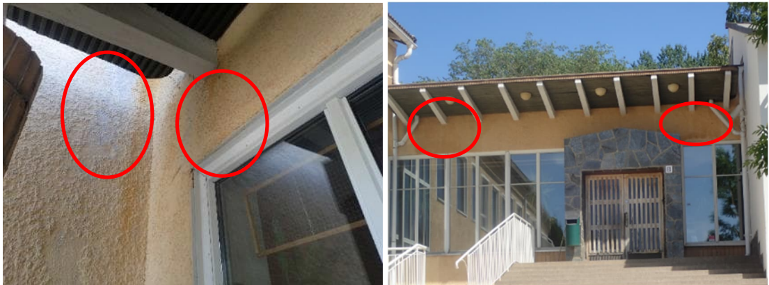
Kuvat 97 ja 98. B-osan sisäänkäyntikatoksien kohdalla havaittiin julkisivuissa kosteusjälkiä (ympyröity).
