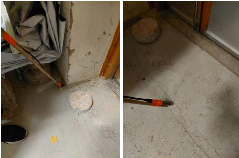
Kuvat 79 ja 80. Varaston 058 ulkoseinän ja alapohjan liittymästä havaittiin merkittävää ilmavuotoa.
