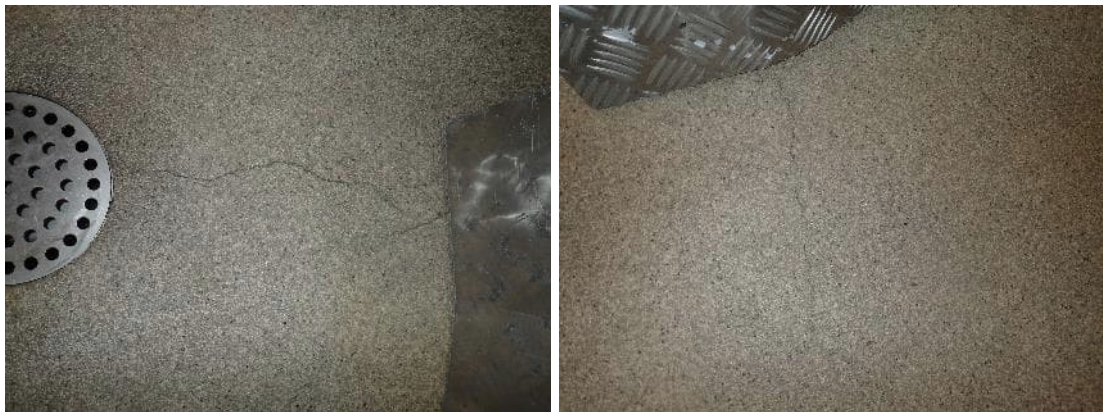
Kuvat 182 ja 183. Keittiön akryylilattioissa havaittiin halkeilua ja kopoa.
