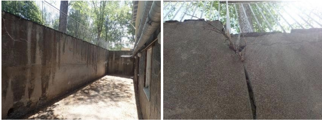
Kuvat 20 ja 21. Luiskan maanpainevallissa havaittiin sekä pysty- että vaakasuuntaisia halkeamia.
