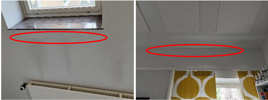
Kuvat 139 ja 140. Halkeilua seinässä auditorion ikkunan alla ja huoneen 119 ulkoseinän yläosassa.
