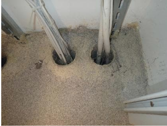
Kuva 188. Välipohjan tiivistämättömät läpiviennit kuivavarastossa
