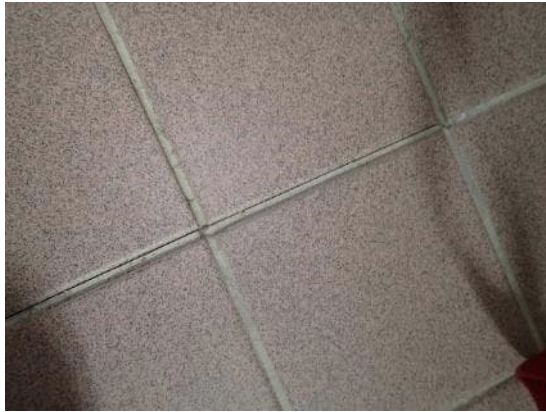
Kuva 181. Keittiön wc:n lattialaatat ovat laajalti kopoja ja laattasaumat ovat halkeilleita.
