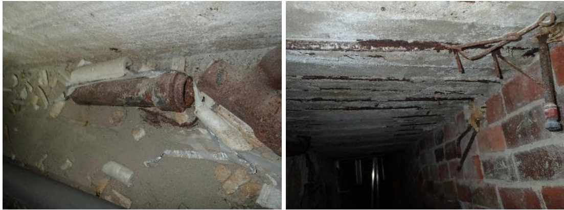
Kuvat 67 ja 68. Kanaalin pohjalla oli vanhoja putken pätkiä ja katossa ruostuneita raudoituksia.
