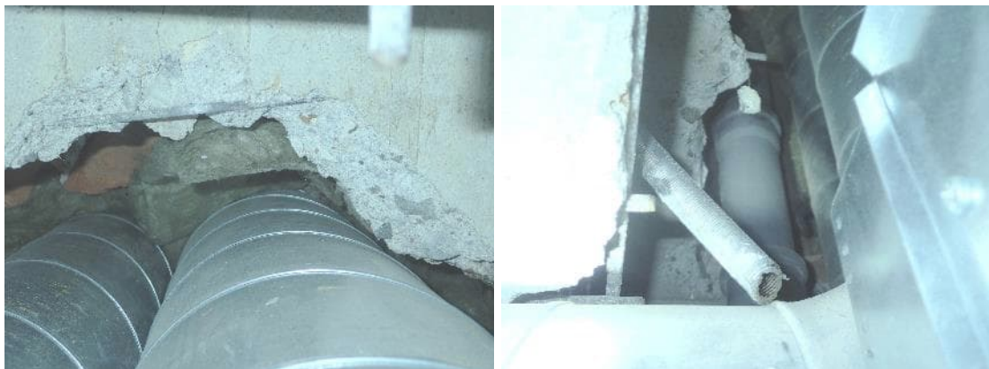
Kuvat 206 ja 207. Rakenneavauksessa R11 havaittiin hyvin epätiivis välipohjaläpivienni.
