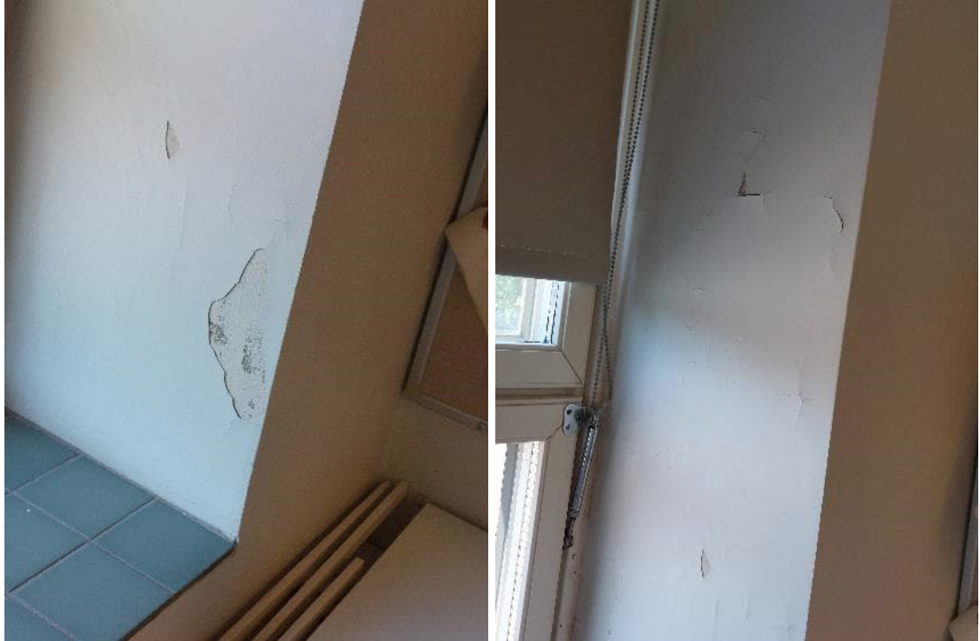
Kuvat 145 ja 146. Ikkunasmyygien maalipinnan lohkeilua G-osan eteläseinustalla.
