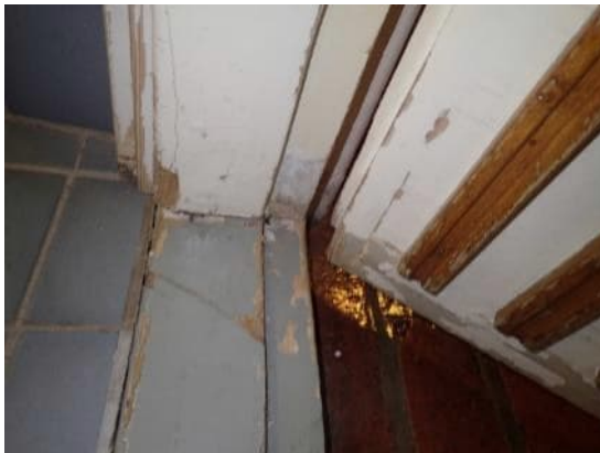
Kuva 52. WC-tilojen kynnyksen liittymä laatoitukseen on epätiivis, ja puuosissa havaittiin kosteusjälkiä.
