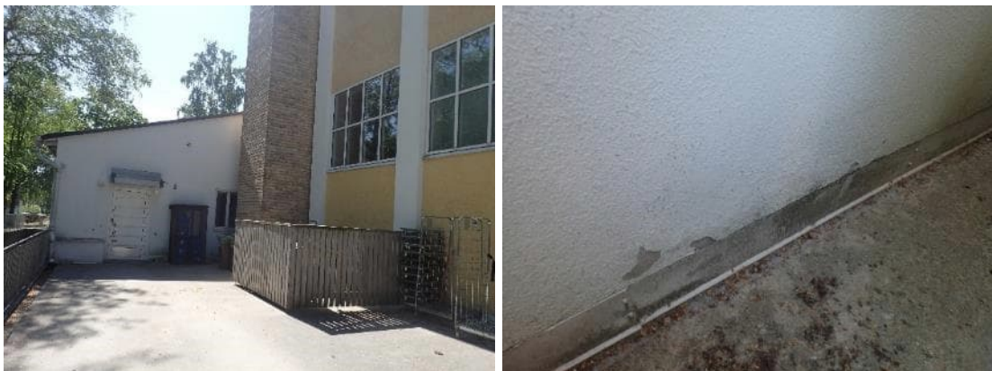
Kuvat 15 ja 16. Keittiön edustalla oleva pihakansi. Keittiön kohdalla ulkoseinän alaosan rappaus kupruilee.
