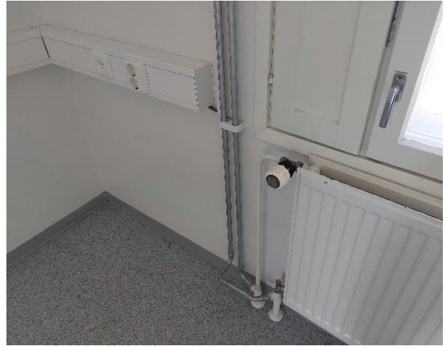
Ilmanvaihtokoneen vesikiertoisen lämmityspatterin liitos patteriverkoston.
