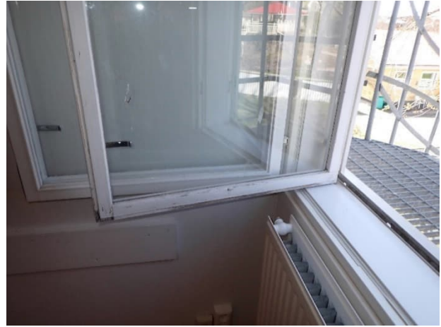
Uusitun ikkunan ulkopuitteen maalipinnan hilseilyä.
