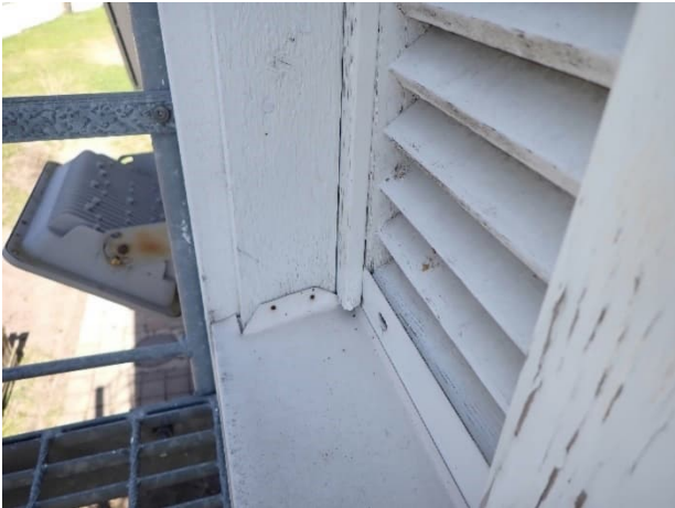
Epätiivis vesipellin liittymä ikkunan pieleen.
