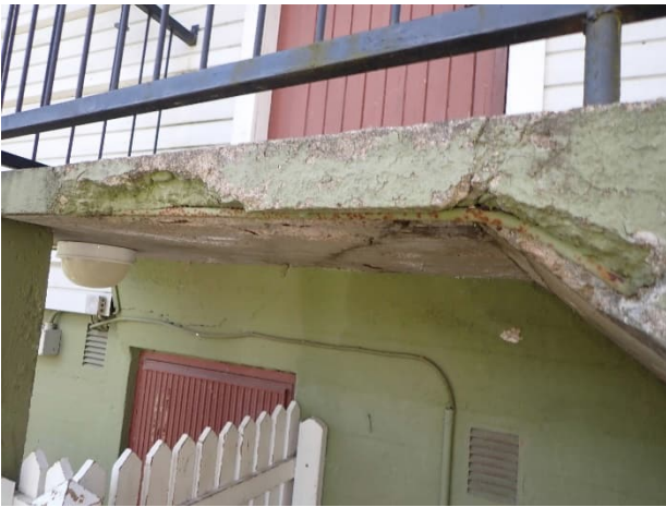
Koillispäädyn portaikko ja tasanteen etupinnan lohkeamat.
