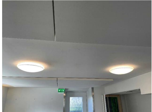
Kellarikerroksen uusitut LED-valaisimet.
