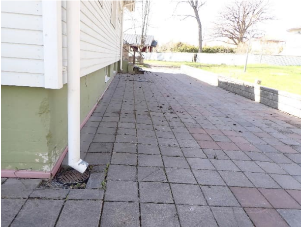
Etupihan kivetystä, joka kallistaa rakennukseen päin aivan rakennuksen vierellä, muutoin pois päin.
