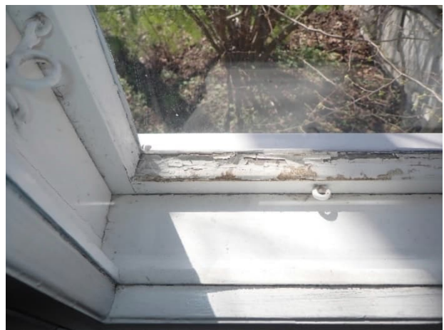
Alkuperäisen ikkunan ulkopuitteen huonokuntoista maalipintaa.
