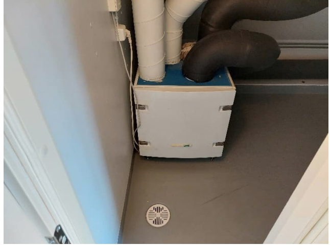
2. kerroksen pienempi IV-kone.
