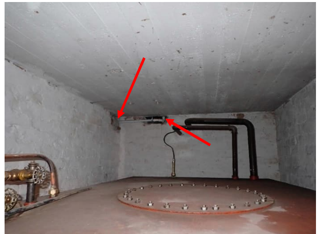
Öljysäiliötila ja sen takaseinällä oleva läpivienti ensimmäisestä kerrosta öljysäiliötilaan ja sieltä viereiseen tilaan.
