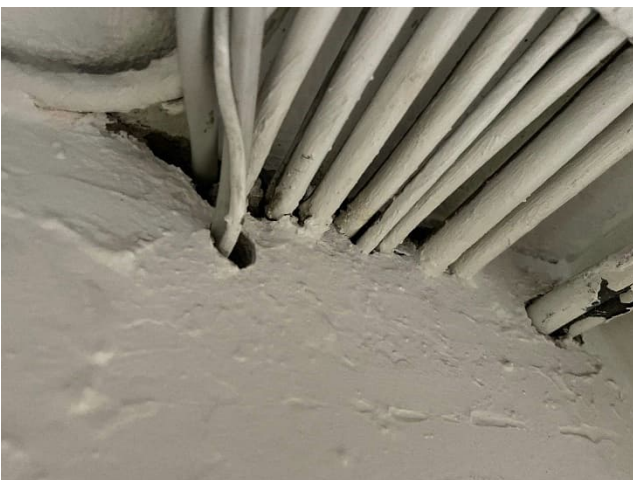
Puutteellisesti tiivistetty läpivienti.
