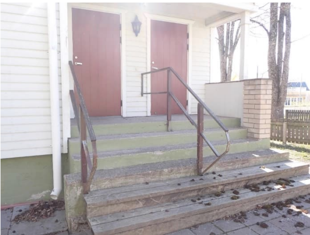
Pääsisäänkäynnin portaikko ja huonokuntoiset kai-teet.
