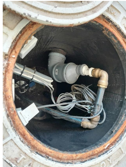
Kellarin alapohjan salaojapumppaamo
