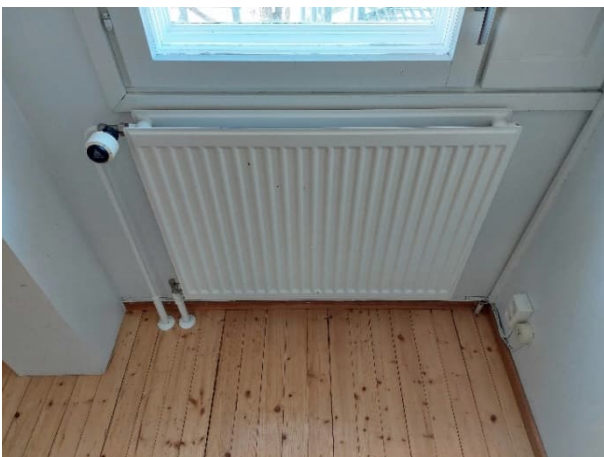
Yleiskuva lämmityspatterista ja patteritermostaatista
