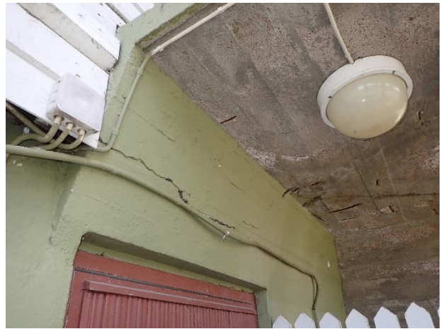
Portaikön ja seinän liittymän vinön osan halkeama sekä tasanteen alapinnan ruostuneita teräksiä.
