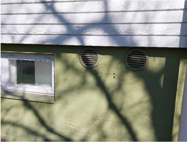
Raitisilmasäleikkö ja jäteilmalaite vierekkäin.
