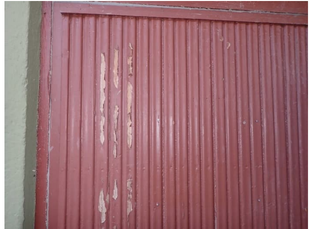
Alkuperäisen oven maalipinnan hilseilyä.
