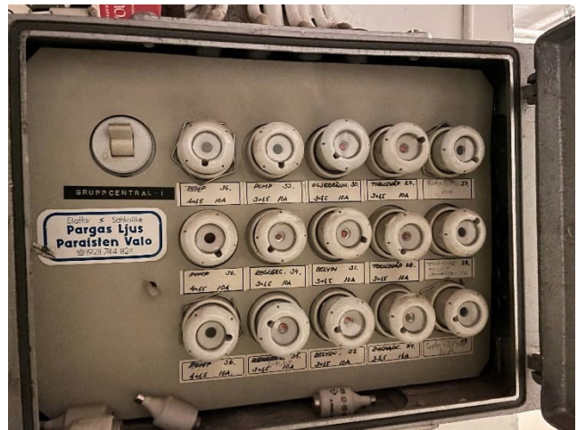
Kiinteistön lämmönjakuhuoneen ryhmäkeskus.
