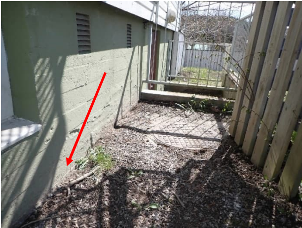
Patolevytyt loppuu betoniseen tarkastuskaivoon rakennuksen lounaispäädyssä.
