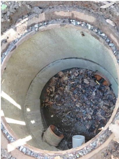
Sadevesikaivon pohjalla runsaasti lehtiä
