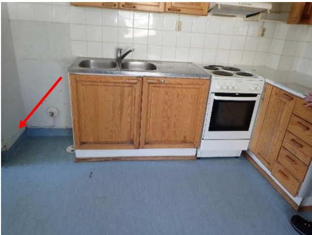
Keittiön kastuneet kaapit sekä mahdollisesti kastunut kotelointi (nuoli).
