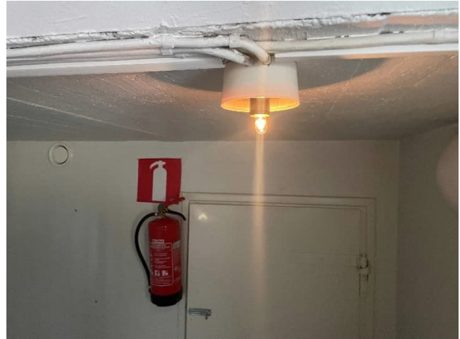
Poistumisopastevalaisimesta puuttuu suojakupu.
