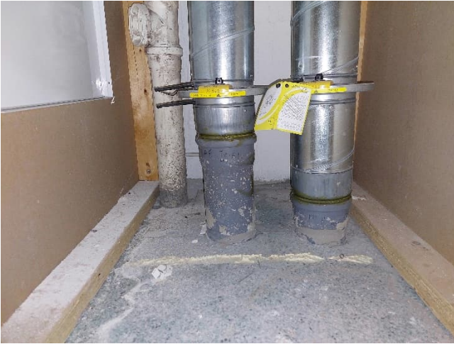
Ilmanvaihtokanavan laatumuutos alapohjaan siirtyessä
